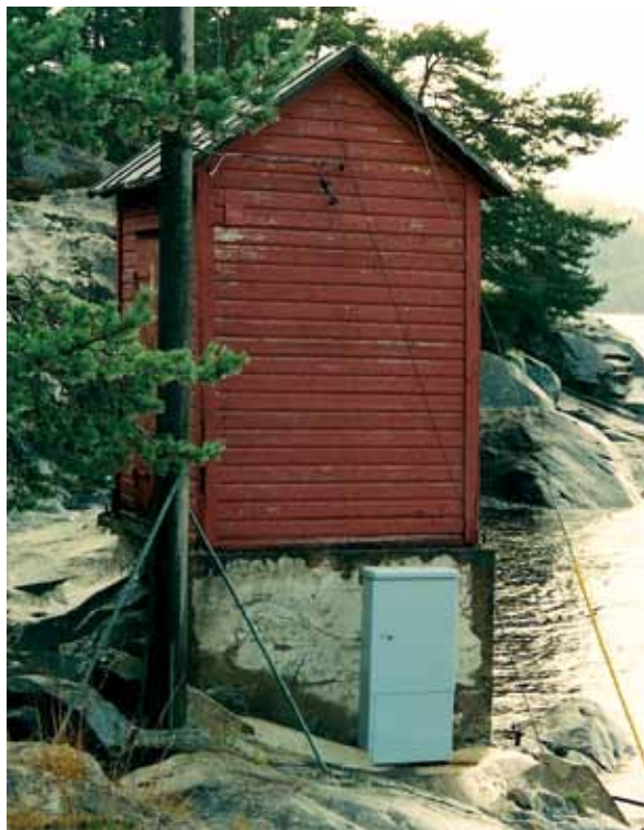
“Den gamle og så den nye tid” – i staden for kabelhus treng ein no berre eit lite koplingssskap.
